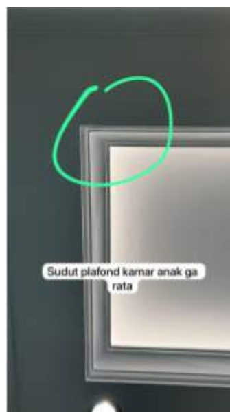
Gambar 4.2.5 sudut plafon kurang rata Sumber : foto pribadi
