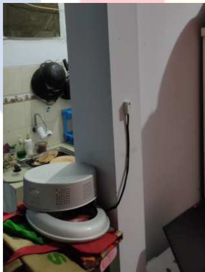
Gambar 5.39 Peletakkan Buzzer (Alarm) 1 Di Area Luar Dapur (Sumber : Dokumentasi Pribadi)
