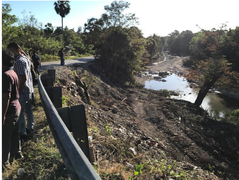
Gambar I.1 Kondisi Longsor pada Proyek (Sumber: BPJN X Kupang)
