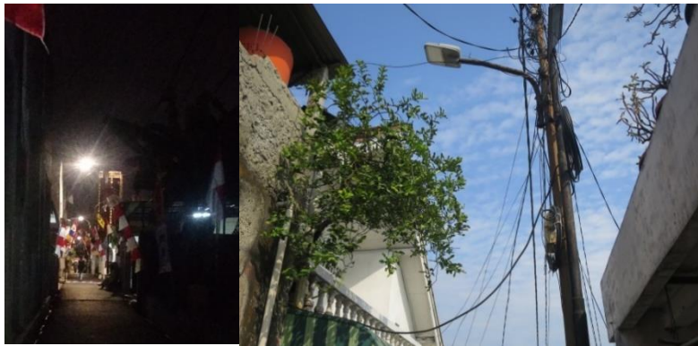
Gambar 1.8 Fasilitas Penerangan Jalan di RW 5 Sumber : Dokumentasi Survei, 2019
