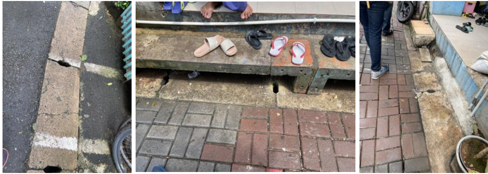
Gambar 22 Kualitas Drainase Setelah Perbaikan (Sumber: Dokumentasi Pribadi, 2022)
