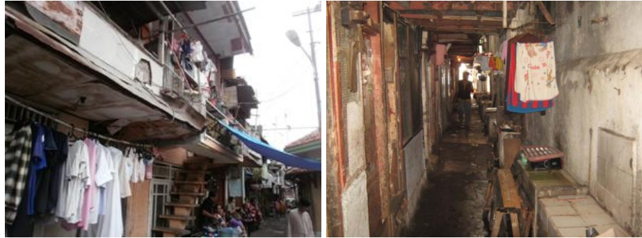
Gambar 9 Kualitas Bangunan Sebelum Perbaikan (Sumber: Dinas Perumahan dan Gedung Pemda DKI Jakarta, 2013)
