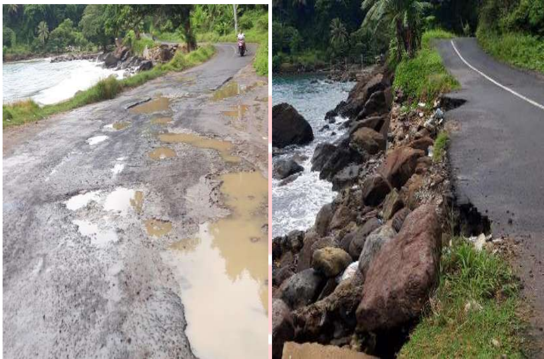
Gambar 12 Kondisi Jalan Rusak di Kecamatan Rajabasa
