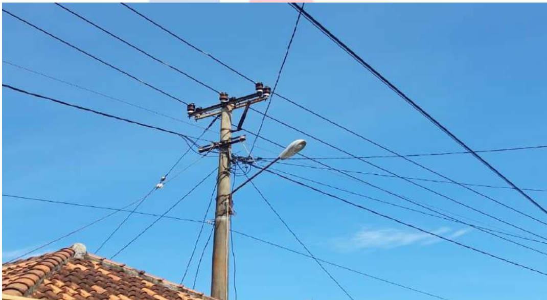
Gambar 17 Kondisi Kabel Listrik di Wilayah Permukiman
