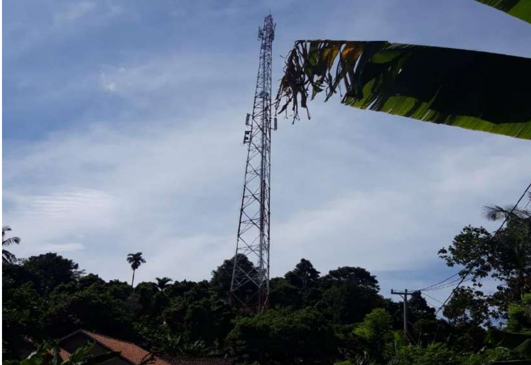
Gambar 20 Kondisi Jaringan Telekomunikasi di Kecamatan Rajabasa
