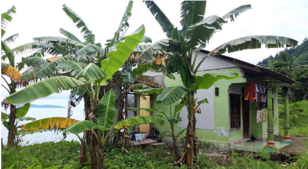
Gambar 4 Kondisi Bangunan Rumah yang Terdampak Tsunami Selat Sunda Tahun 2018 di Kecamatan Rajabasa
