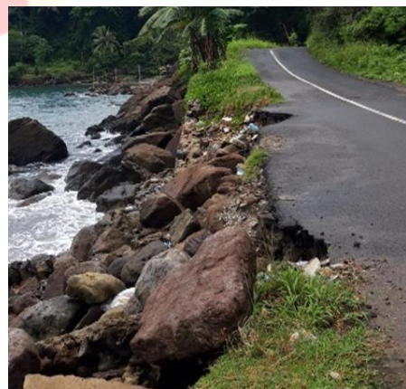
Kondisi jalan provinsi di Kecamatan Rajabasa
