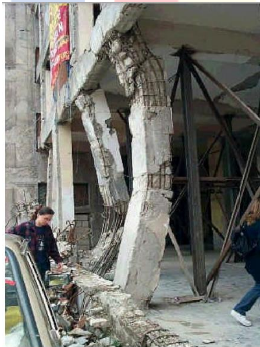
Gambar I.3 Kerusakan Kolom Akibat Pemasangan Sengkang yang Salah Sumber: Jurnal Ilmiah Media Engineering
